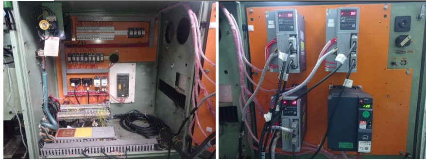
Gambar 6. Kondisi Panel box baru
