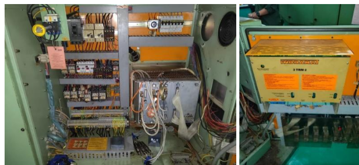
Gambar 5. Kondisi Panel box lama
